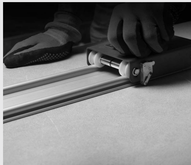
CUTTING DETAIL WITH GUIDE ON SLAB DETALLE DE CORTE CON GUÍA SOBRE PLANCHA
